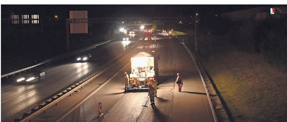
Risikant: Die noch befahrbare linke Spur grenzt unmittelbar an die Baustelle.
